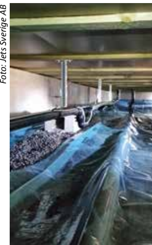
Ledning i kryppgrund.
