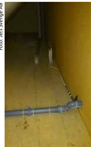
Ledning på vind.
