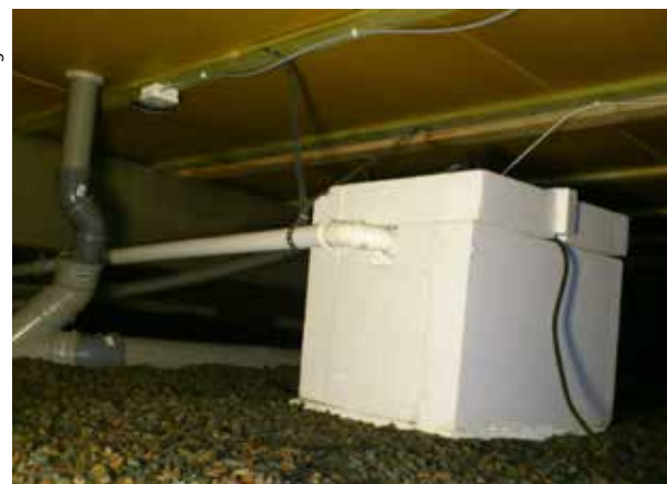
Isolerad vakuumenhet i kryppgrund.
