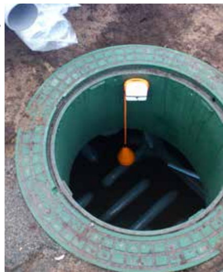
Tank med larmvippa och anslutna ledningar.
